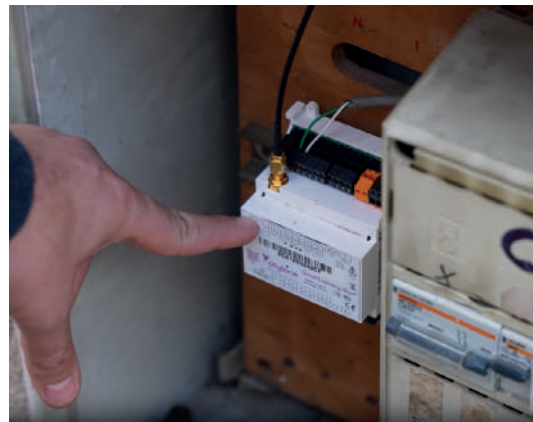
Installation d'une horloge connectée dans une armoire électrique dédiée à l'éclairage public
