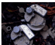
Compteurs d'eau communicants (têtes émettrices LoRa)
