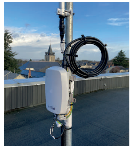
Déploiement d'une passerelle LoRa sur un toit terrasse
